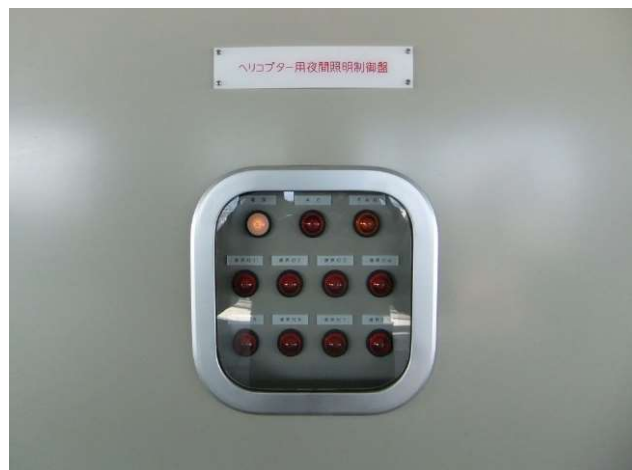
ヘリポート照明制御盤 表示ランプ例
