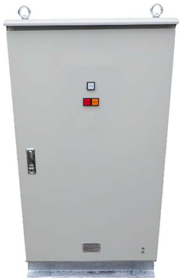
ヘリポート照明制御盤（屋外自立型）
